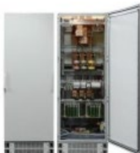
Шкаф ввода возбуждения
