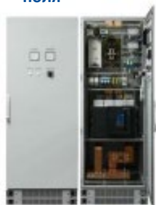
Шкаф гашения поля
